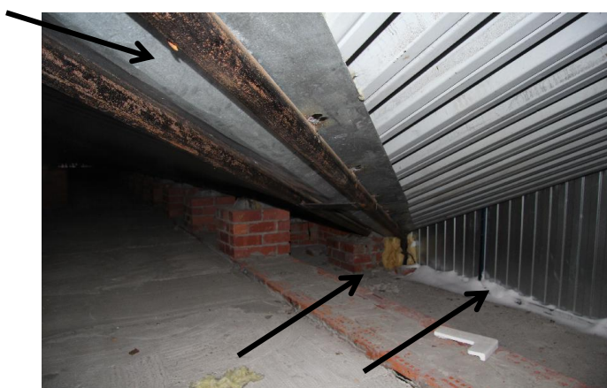
Фото №4 Отсутствие связей и снег
