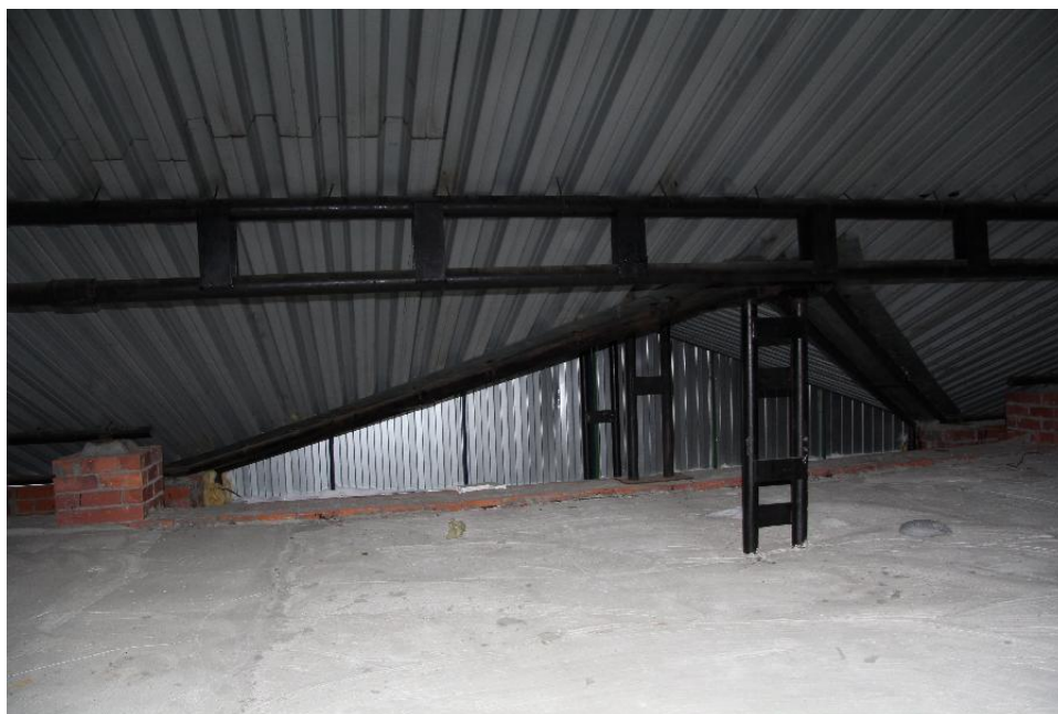
Фото №3. Промежуточные опоры под Р-2 по оси В-В отсутствуют.
